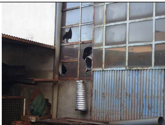
Imatge 5: vidres trencats a la sala de rebarbar
