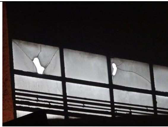
Imatge 4: vidres trencats a la sala de fusió
