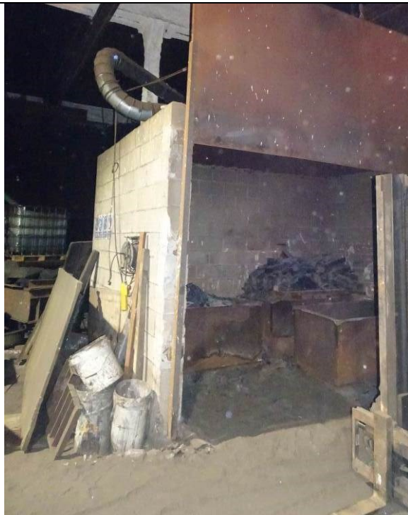
Imatge 11: nova sala de refredament de peces
