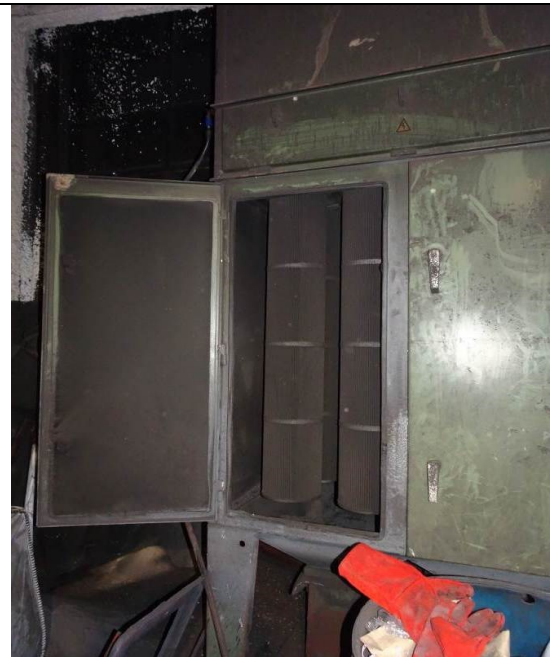
Imatge 10: armari de filtres de cartutxos de la sala de rebarbar corresponent al nou sistema de recirculació de fums de la sala de fusió
