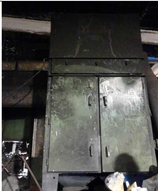
Imatge 9: armari de filtres de cartutxos de la sala de rebarbar corresponent al nou sistema de recirculació de fums de la sala de fusió
