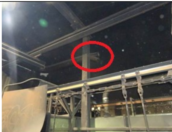
Imatge 13: extrem del conducte d'entrada de fums sobre el carrusel, corresponent a la nova instal·lació de recirculació de fums
