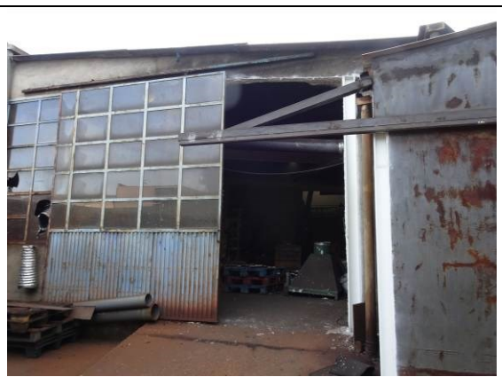
Imatge 6: portal d'accés a la sala de rebarbar encallat
